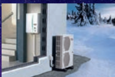
Pompe à chaleur
