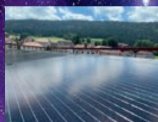
Installation photovoltaïque Communauté d'autoconsommation
