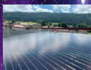
Installation photovoltaïque Communauté d'autoconsommation
