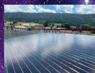
Installation photovoltaïque Communauté d'autoconsommation
