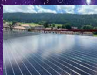
Installation photovoltaïque Communauté d'autoconsommation
