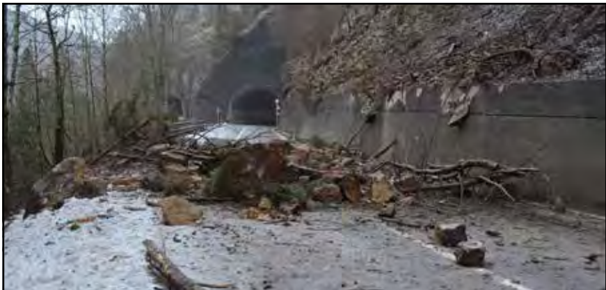
C'est juste à l'entrée du tunnel que s'est produit l'éboulement.
