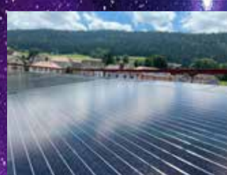
Installation photovoltaïque Communauté d'autoconsommation
