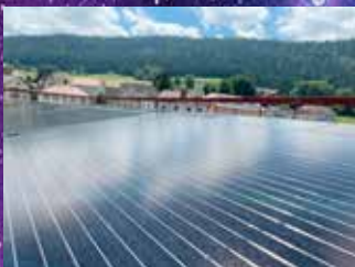
Installation photovoltaïque Communauté d'autoconsommation
