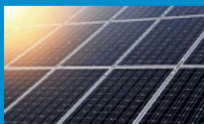
Installation photovoltaïque Communauté d'autoconsommation
